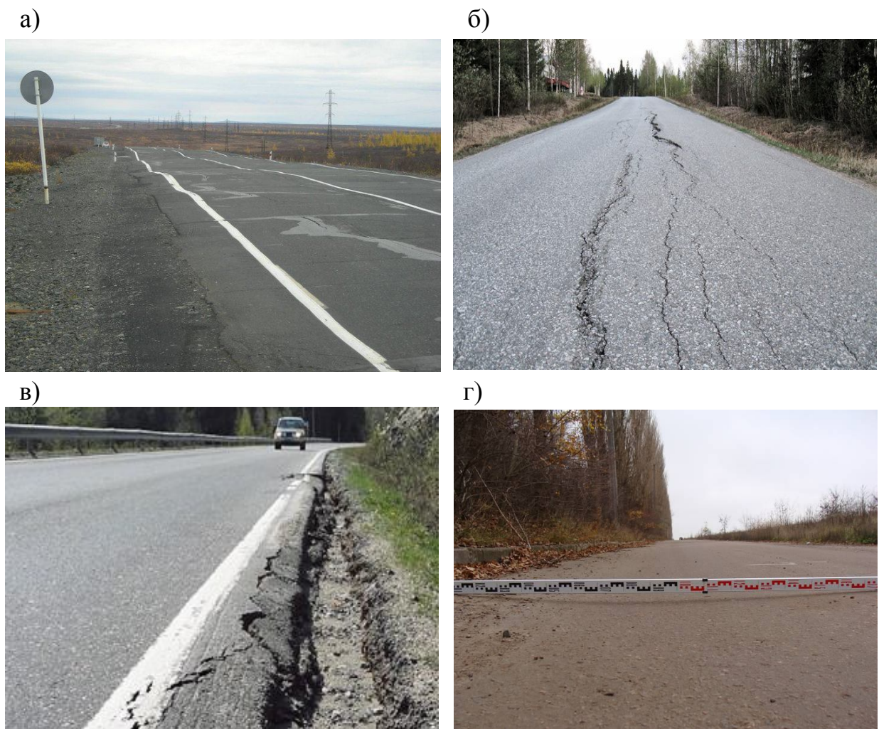
Рисунок 1.1 – Руйнування та деформації дорожнього одягу під впливом вологості ґрунту: а) просядка; б) поздовжні тріщини; в) обломлювання крамок проїзної частини б) колія
