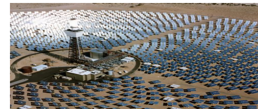
Рис. 1.6 - Сонячна термодинамічна електростанція
