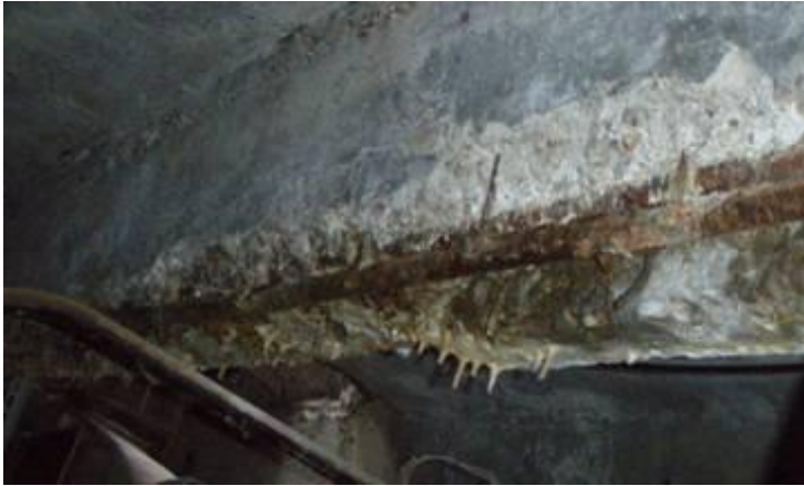
Рис.2. Корозія бетону поперечної балки з оголенням і корозією робочої арматури внаслідок термомеханічного циклічного навантаження
