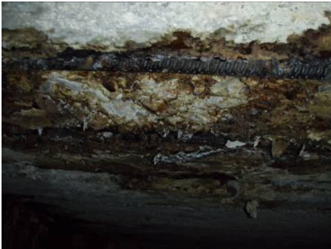
Рис.3. Корозія бетону дрібнозернистих плит з оголенням робочої арматури в будівлі виробничого корпусу
