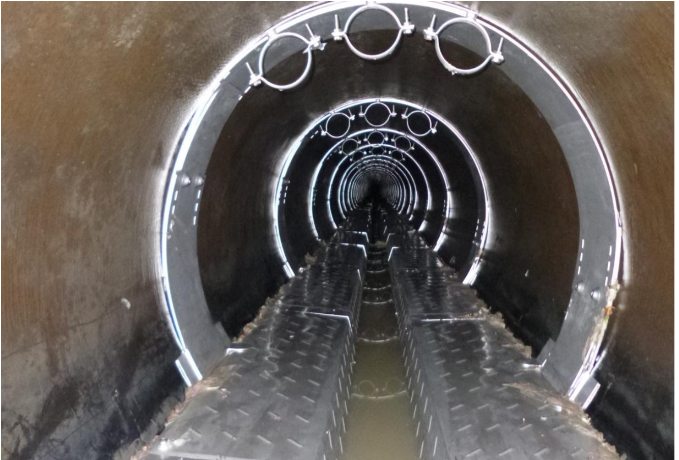
Рис.2 – Загальний вигляд теплообмінника, який розміщений всередині стічних труб
