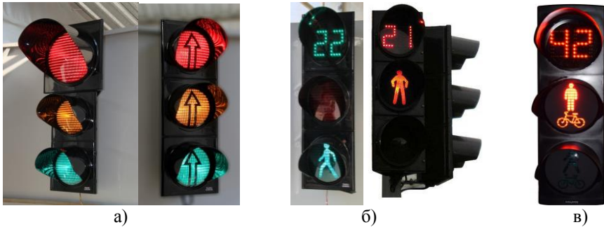
Рис. 1. Світлофори різного призначення: а - транспортний світлодіодний; б - пішохідний світлофор з відліком часу; в - світлофор з відліком часу для регулювання пішохідних та велосипедних напрямків руху
