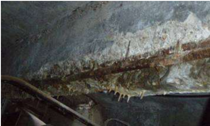
Рис.2. Корозія бетону поперечної балки з оголенням і корозією робочої арматури внаслідок термомеханічного циклічного навантаження
