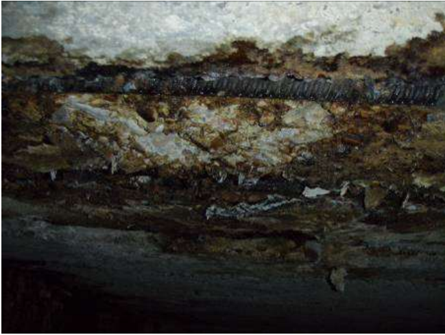
Рис.3. Корозія бетону дрібнозернистих плит з оголенням робочої арматури в будівлі виробничого корпусу
