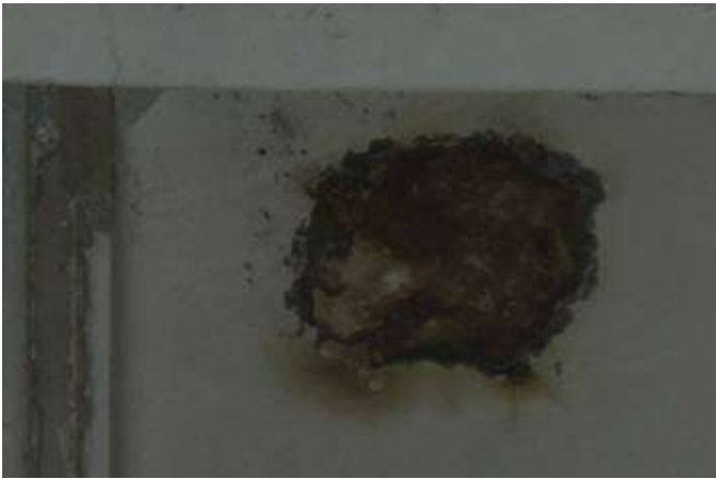
Рис.4. Корозія бетону плити покриття виробничої будівлі
