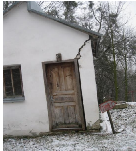
Рис. 2. Фотофіксація тріщини (деформації) споруди на території Підгорецького монастиря
