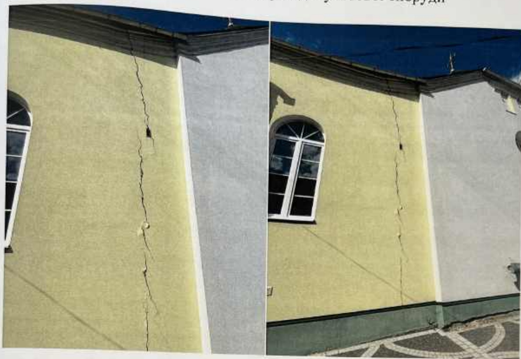
Дефекти виявлені на фасаді культової споруди
